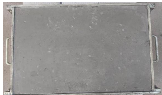
(d) No Crack after 2 hours
