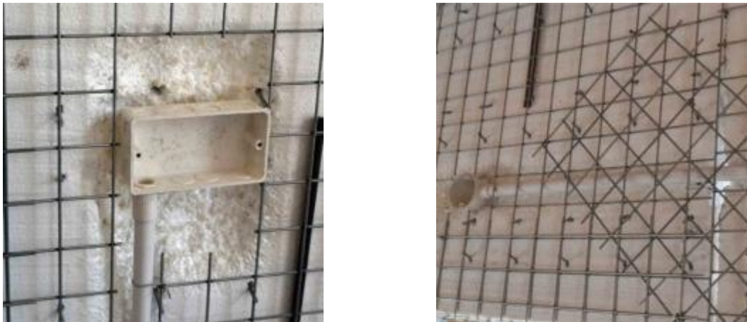
Fig. 8. Electric conduits provisions [15]
